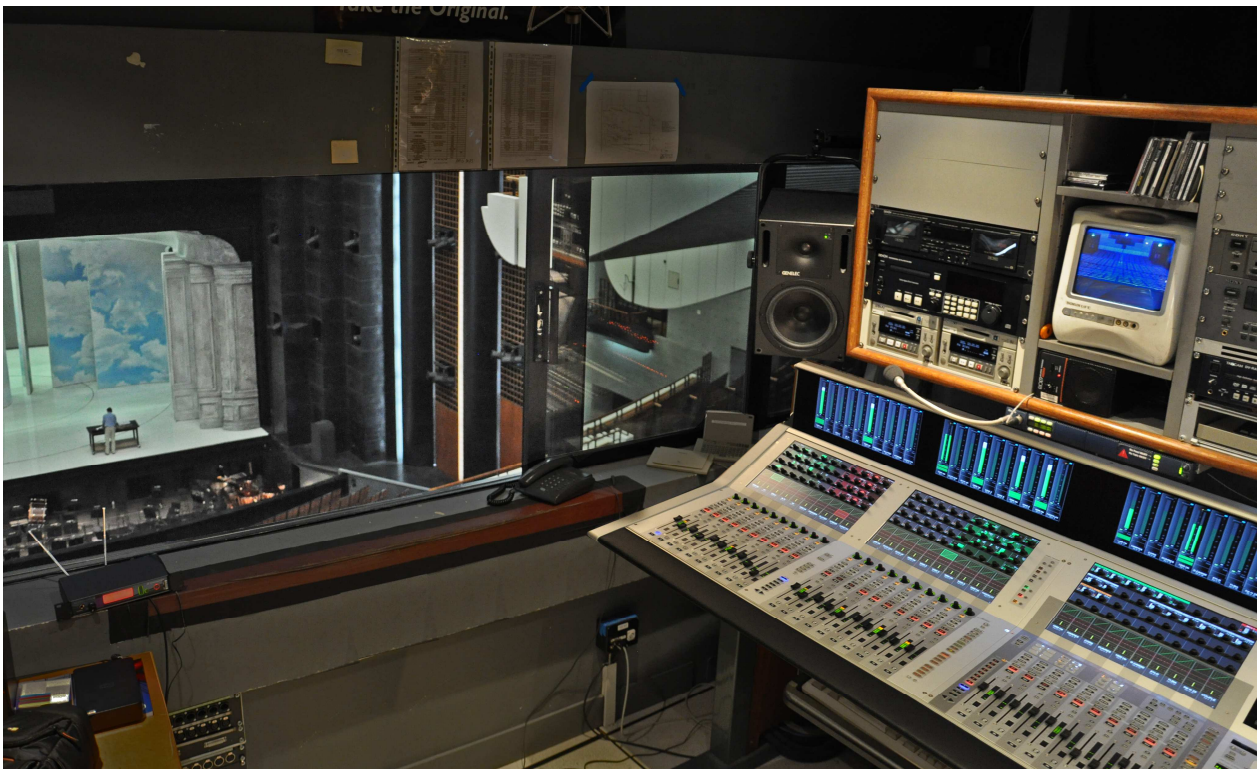
La régie de l'Opéra Bastille, console STUDER, enceintes GENELEC, intercom filaire et sans fil numérique CLEAR-COM
